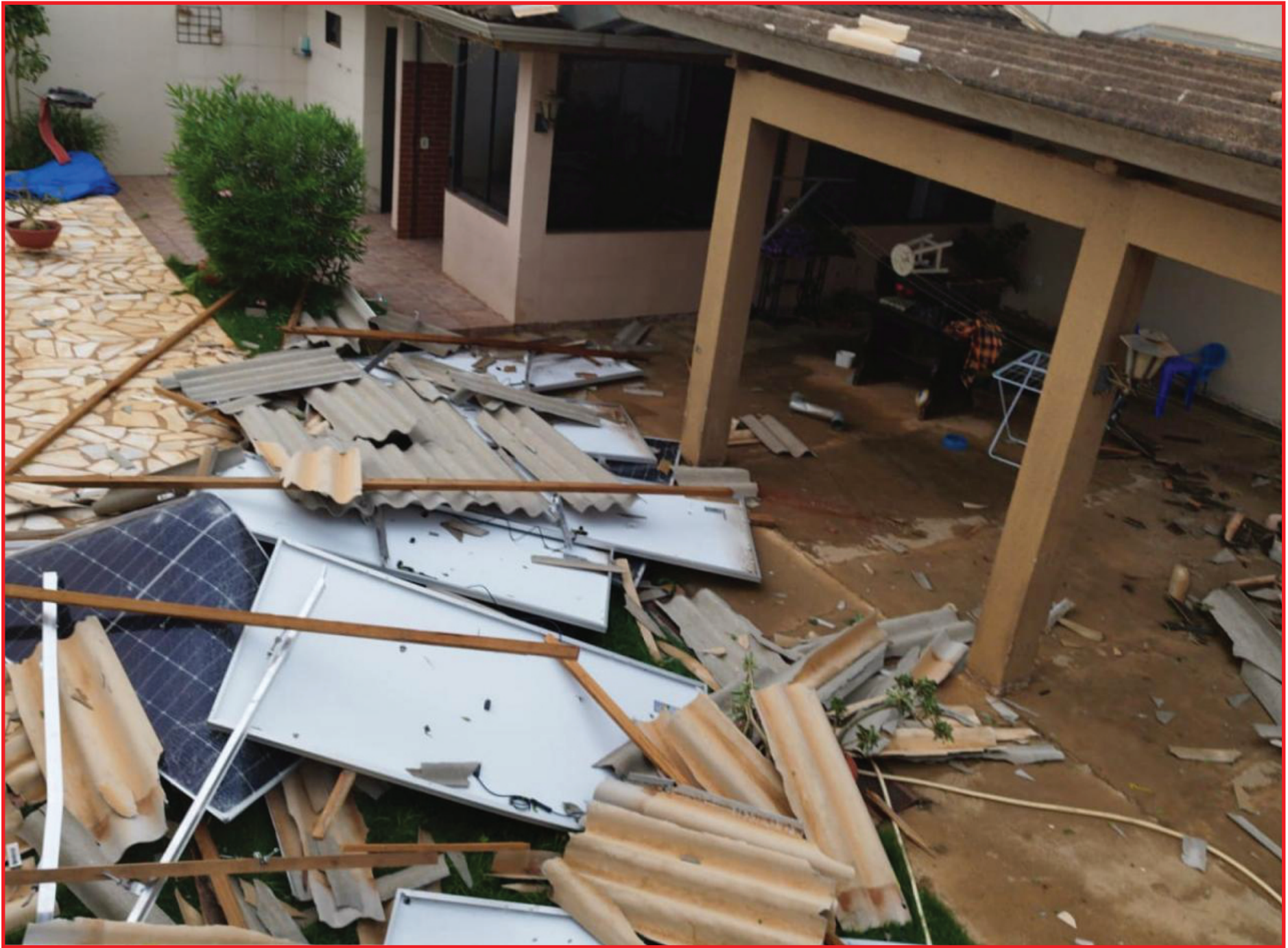
Marquises, placas e cobertura de alguns armazéns e empresas foram arrancadas
