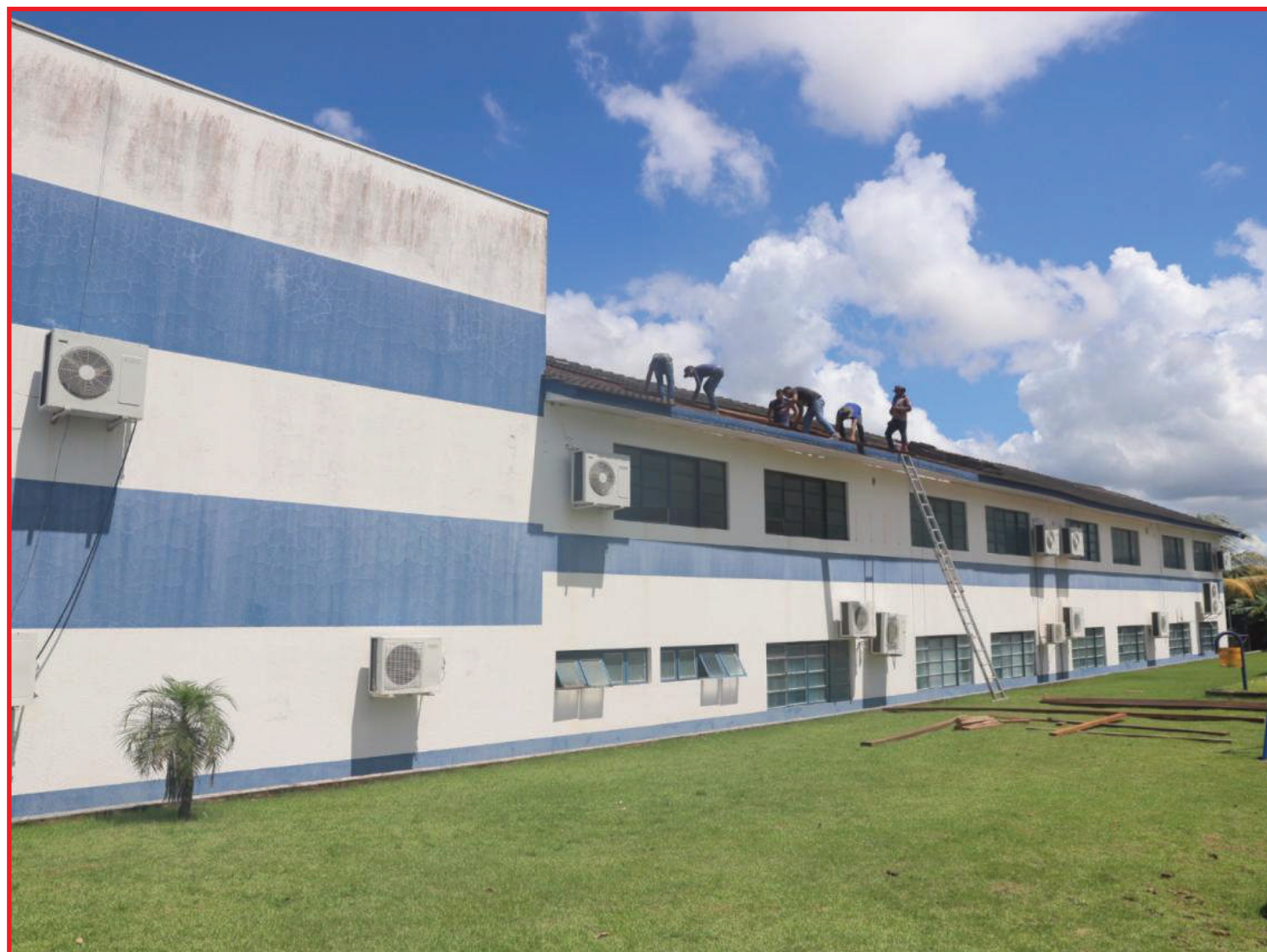
Exceção é a CMEB Sorriso, que passa por reparos emergenciais
