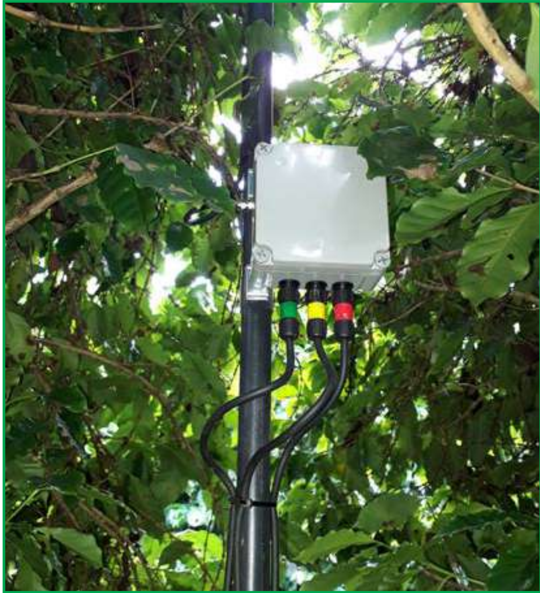
Sistema emite relatórios de operações e alertas que funcionam independente da rede elétrica
