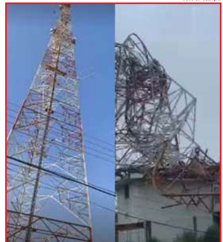
Estrutura ficou danificada
