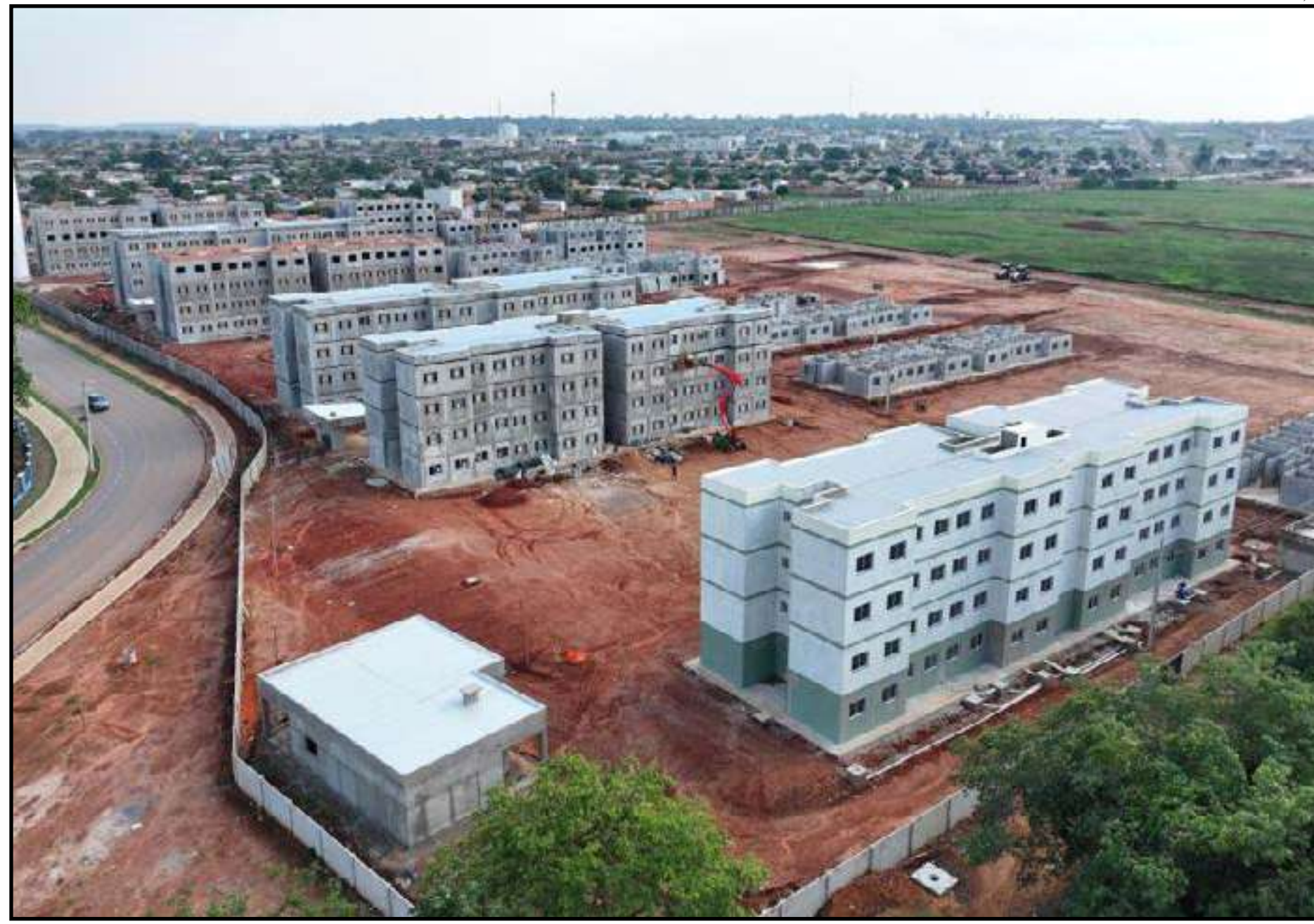
Residencial do Programa SER Família Habitação que está em construção em Lucas
